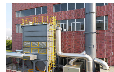
粉塵收集設備
