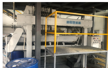
廢渣處理設備
