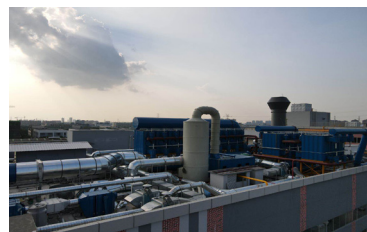
廢氣處理設備
